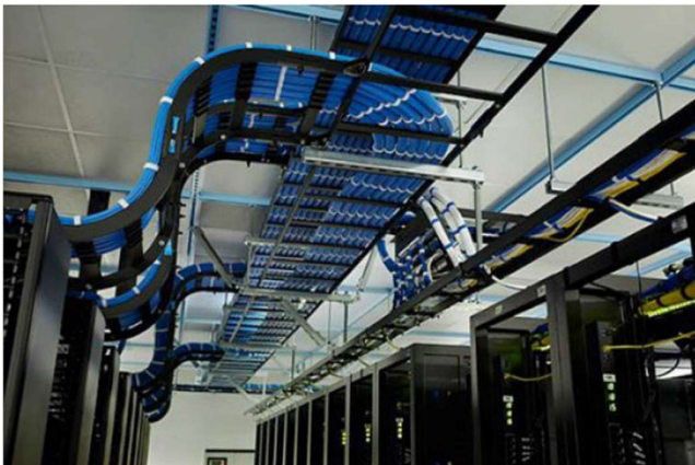
Data Hall ใน Data Center
